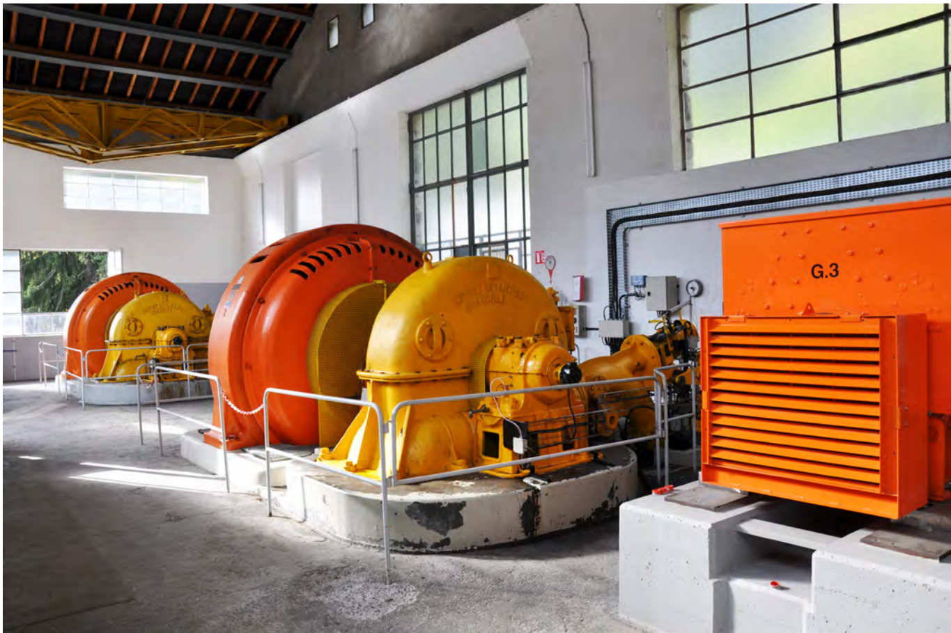
Salle des machines de la centrale des Pérelles.
