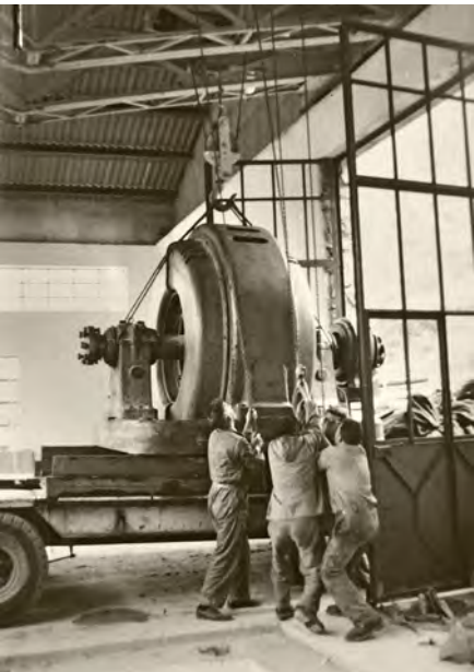
Installation de l'un des groupes de la centrale des Pérelles.
