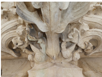
Détails des altérations de la pierre.
